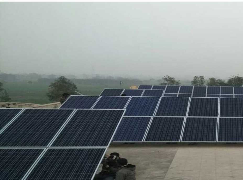
PV-Solaranlage auf dem Dach der St. Mary`s School, Rohtak, Haryana
