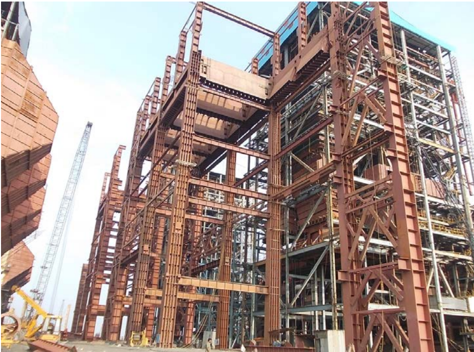
Wärmeleistungwerk Barauni in Barauni, Bihar
