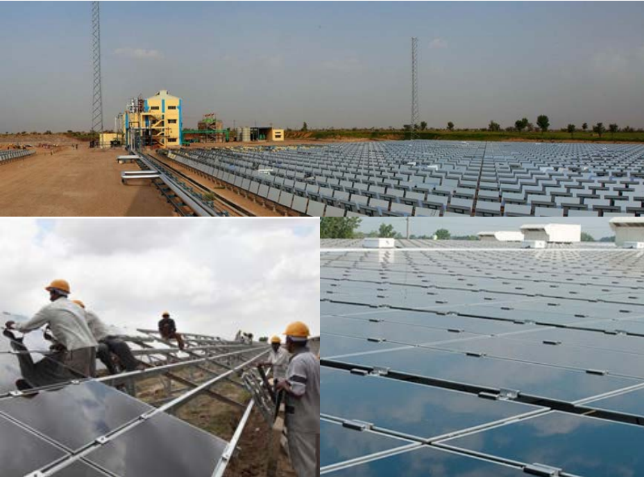
Solarparks von ACME
