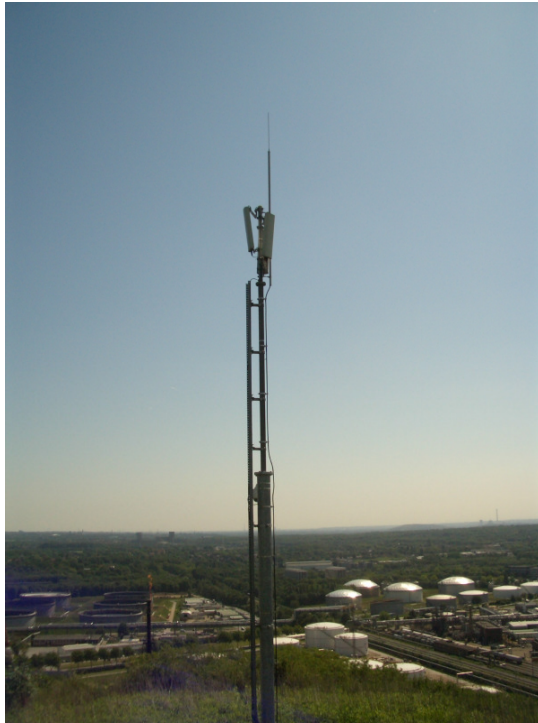
Bild 1: Auf der Halde Scholven ragt der Antennenmast der seNet ® - Basisstation hoch über das BP Werksgelände hinaus.
